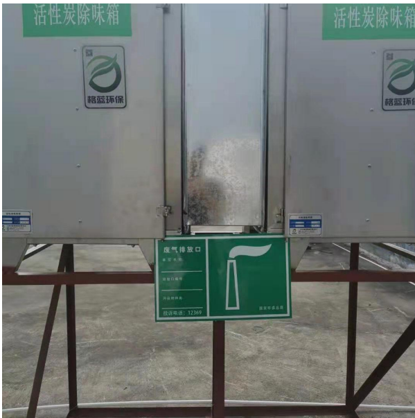
项目厂区废气排放口标志
